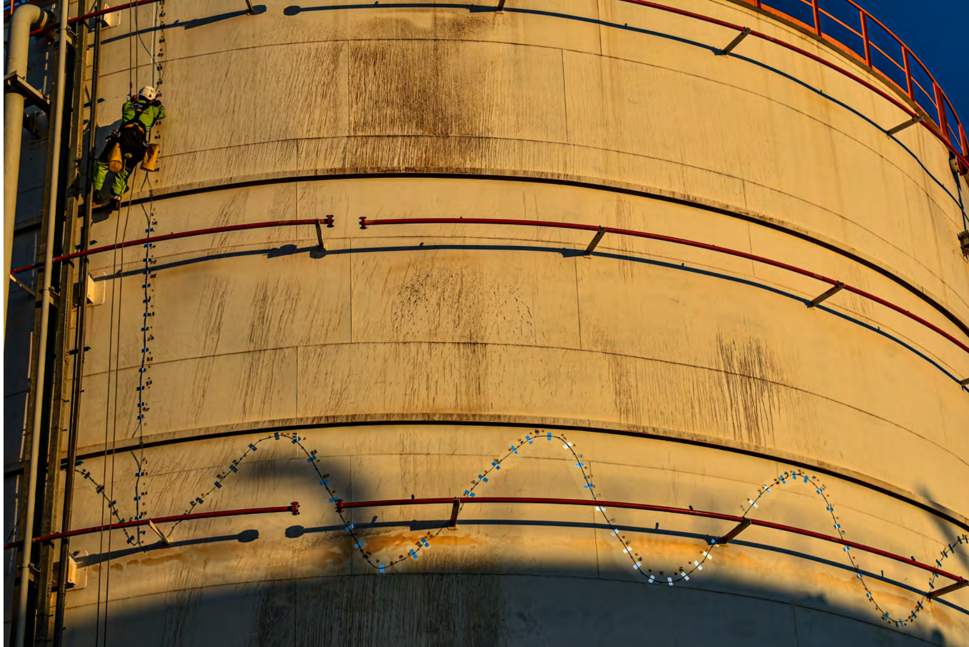
سال 1399 - نصب سنسورهای LHD - عسلویه - پتروشیمی مرجان
